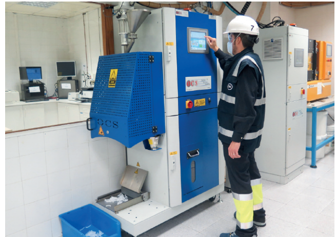
OP5 在线测量装置在客户西班牙 TDE工厂使用
