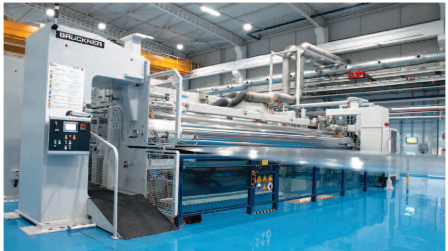
高效的薄膜拉伸生产线
