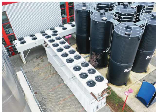
Kälte-Container und Trockenkühler finden geschützt zwischen den Materialsilos auf dem DRS-Außengelände Platz (Alle Bilder, Quelle: Reisner Cooling Solutions)
