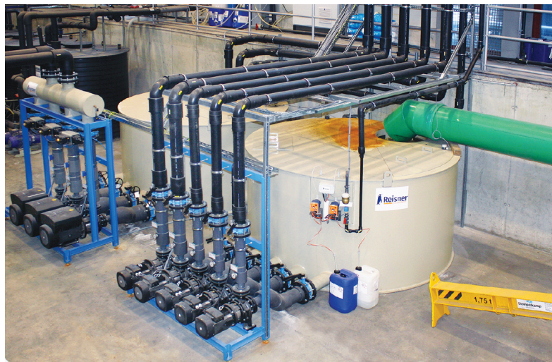
Riesige, maßgefertigte Reisner-Tanks halten das Kühlwasser perfekt vor. Die Verrohrung hat Reisner sauber ausgeführt – auf speziellen Wunsch mit Material der FRANK-Gruppe
