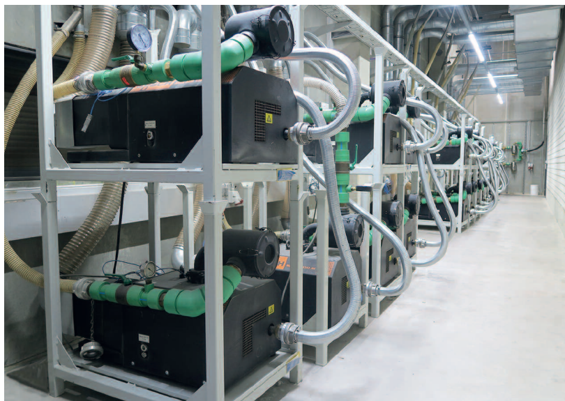
Bild 2: Blick in den Maschinenraum mit den MINK Klauen-Vakuumpumpen von Busch, die verschiedene Förderkreise mit Vakuum versorgen (Bild: Busch Vacuum Solutions)
