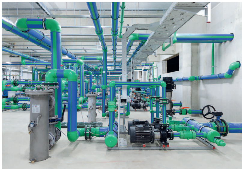
Bild 1: Rohrleitungen eines Kühlwasseraufbereitungssystems in einem Industriebetrieb (Bild: aquatherm)
