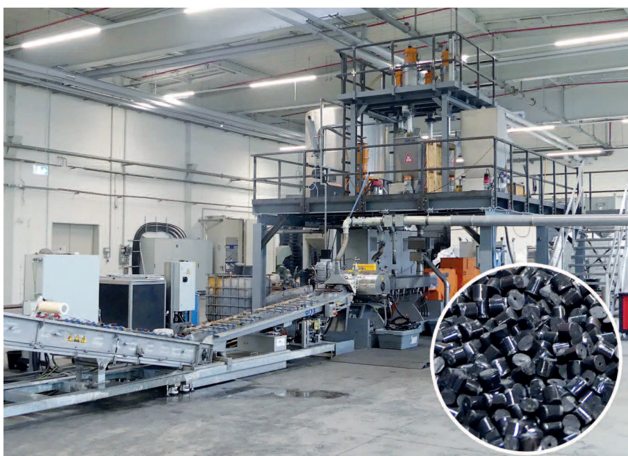
Neue Extrusionslinie mit Maag Ettlinger Hochleistungsschmelzefilter (Bildquelle Sysplast)
