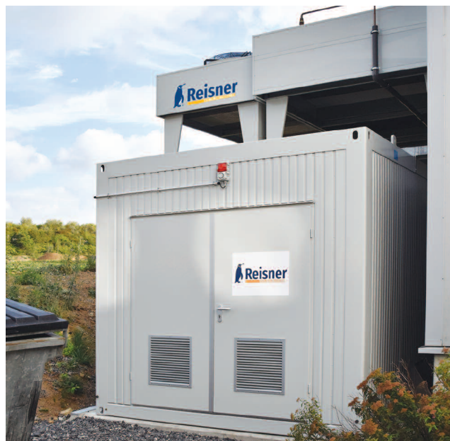
Containerkühlanlage neben der Halle, Trockenkühler auf dem Dach: Die Kälte-Erweiterung bietet eine besonders „aufgeräumte“ Lösung
